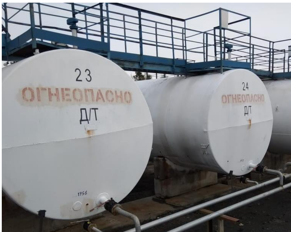
Рисунок 1 – Общий вид резервуаров РГС-50
