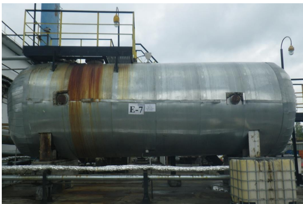
Рисунок 1 – Общий вид резервуаров стальных горизонтальных цилиндрических РГС-50
