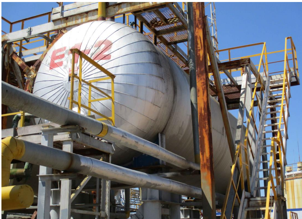
Рисунок 1 – Общий вид резервуаров РГС-60
