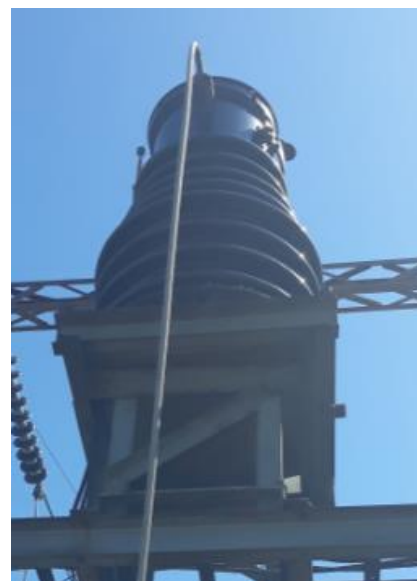
Рисунок 2 – Общий вид трансформаторов тока ТФНД-110М-II с заводскими номерами 249; 266; 272; 279; 290; 399
