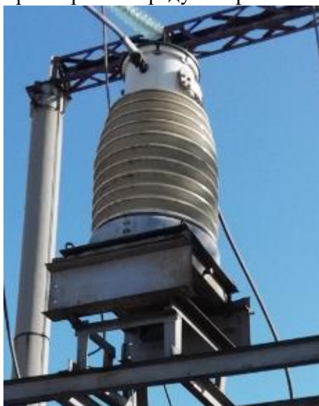
Рисунок 1 – Общий вид трансформаторов тока ТФНД-110М-II с заводскими номерами 4749; 4754
