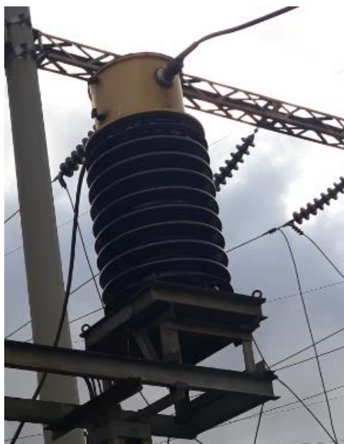
Рисунок 3 – Общий вид трансформаторов тока ТФНД-110М-II с заводскими номерами 28; 30; 31; 33; 35; 39; 40; 760; 1213; 1240; 1922; 2003; 2009; 2227; 2231; 2383; 2384; 2386; 2387
