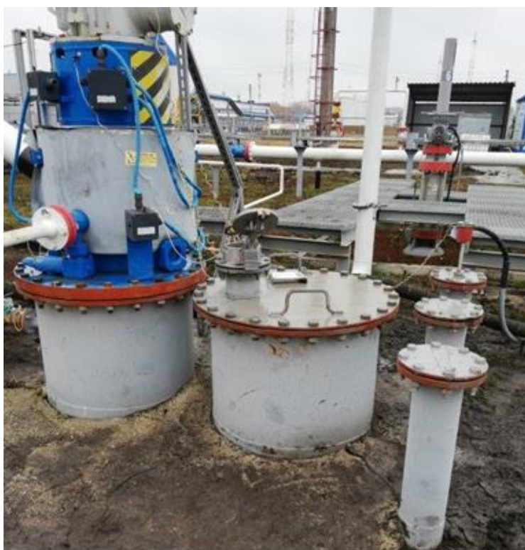
Рисунок 1 – Общий вид места установки резервуара РГС-8 с заводским номером 3615
