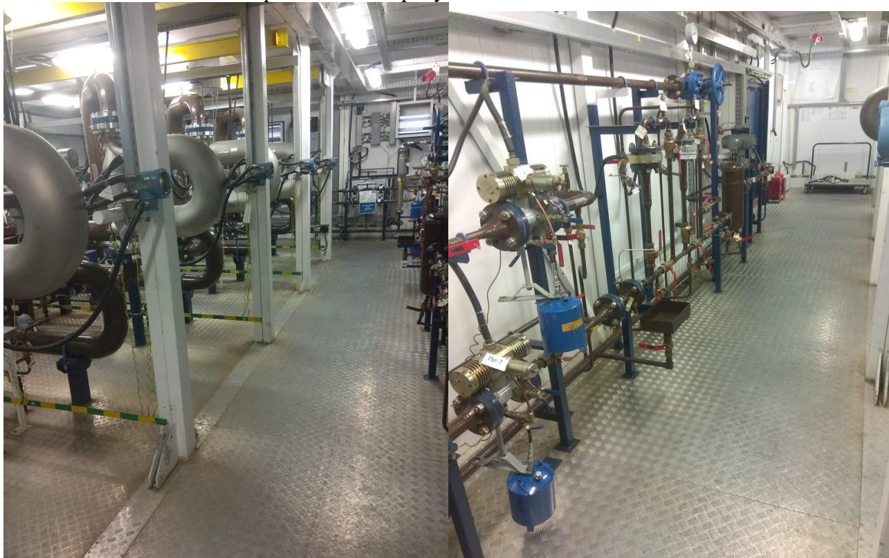
Рисунок 1 – Общий вид СИКН
