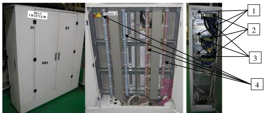
1 – контроллеры cRIO-9074; 2 – модули ввода сигнала с термопар cRIO-9214; 3 – цифровые TTL модули ввода NI cRIO-9401; 4 – клеммные соединения (WAGO) Рисунок 4 – Шкаф ША3. Общий вид и внутреннее устройство (вид спереди и справа)
