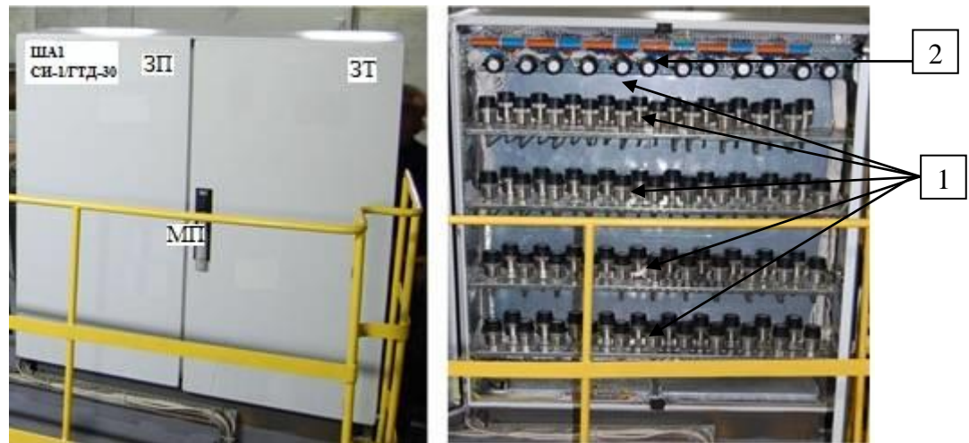
1 – преобразователи измерительные давления ЗОНД-10; 2 – клеммные соединения (WAGO) Рисунок 2 – Шкаф ША1. Общий вид и внутреннее устройство (вид спереди)
