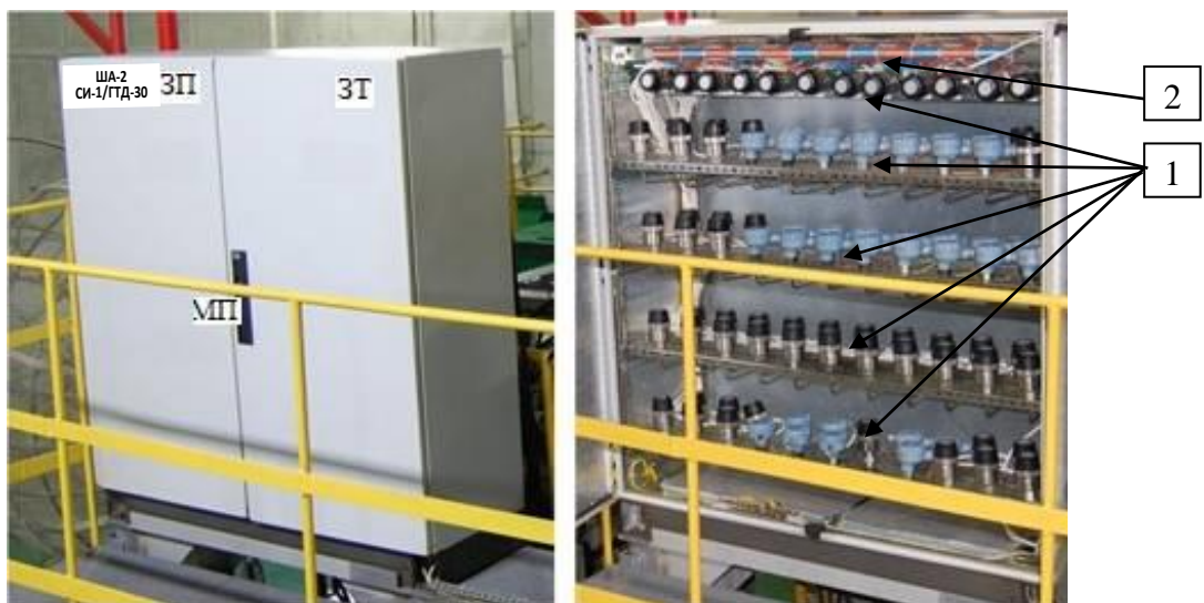
1 – преобразователи измерительные давления ЗОНД-10; 2 – клеммные соединения (WAGO) Рисунок 3 – Шкаф ША2. Общий вид и внутреннее устройство (вид спереди)
