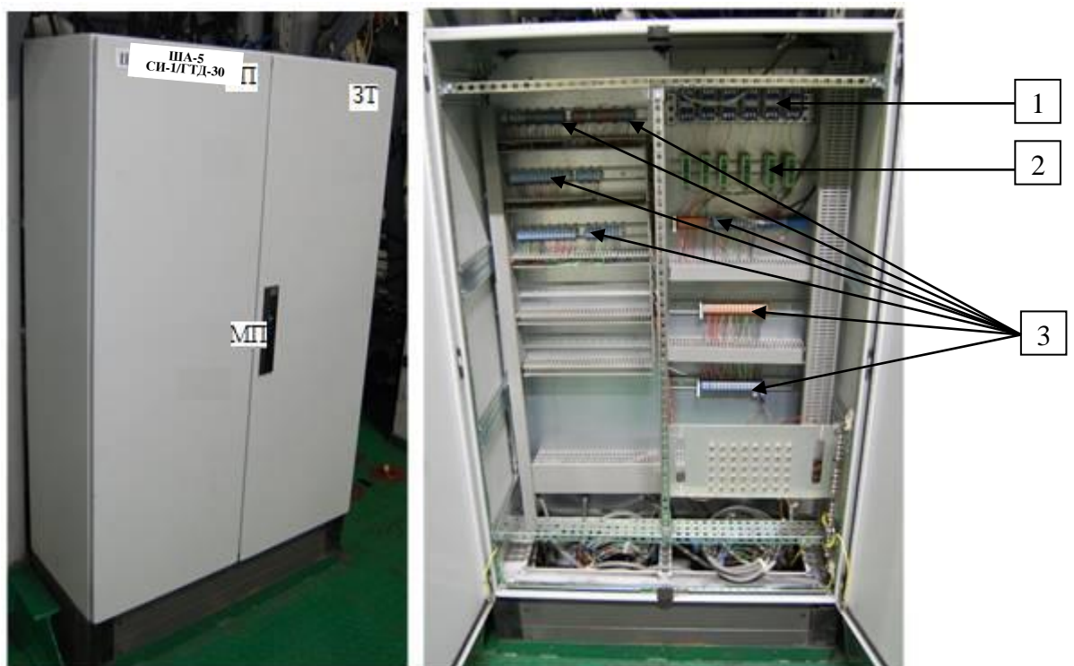
Рисунок 5 – Шкаф ША4. Общий вид и внутреннее устройство (вид спереди)
