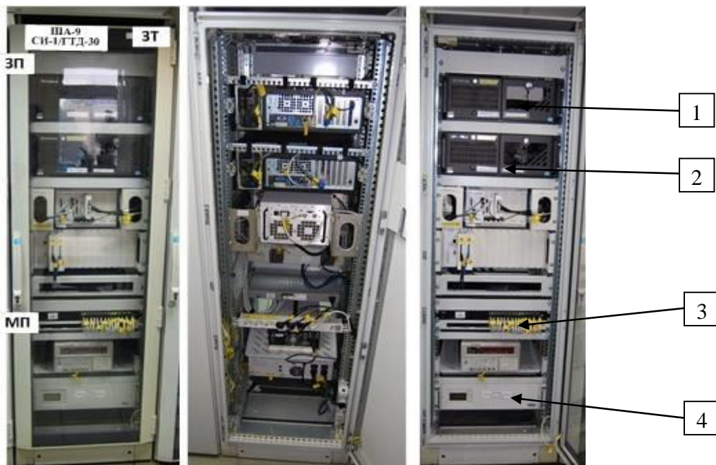
Рисунок 9 – Шкаф ША8. Общий вид и внутреннее устройство (вид спереди и с тыльной стороны)
