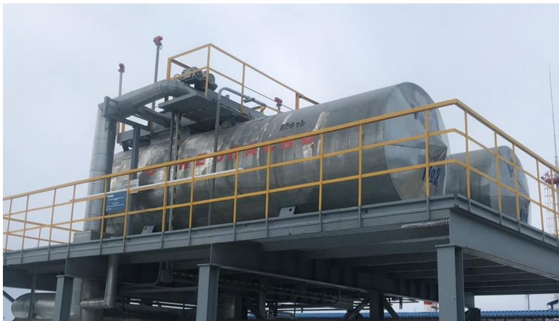
Рисунок 1 – Общий вид резервуаров РГС-20
