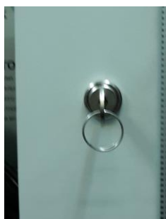
Рисунок 3 - Внешний вид замка на дверце электромонтажного шкафа №1
