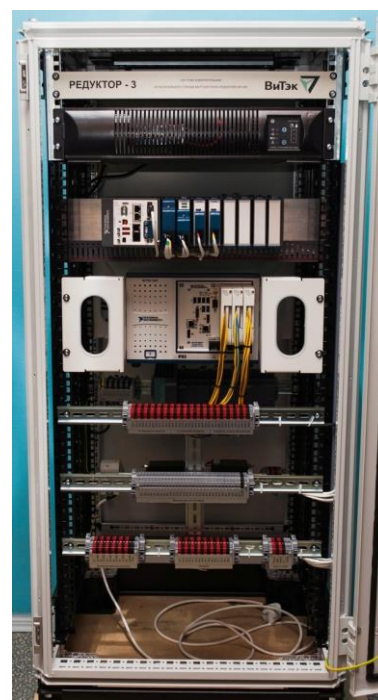
Рисунок 2 - Общий вид электромонтажного шкафа №2
