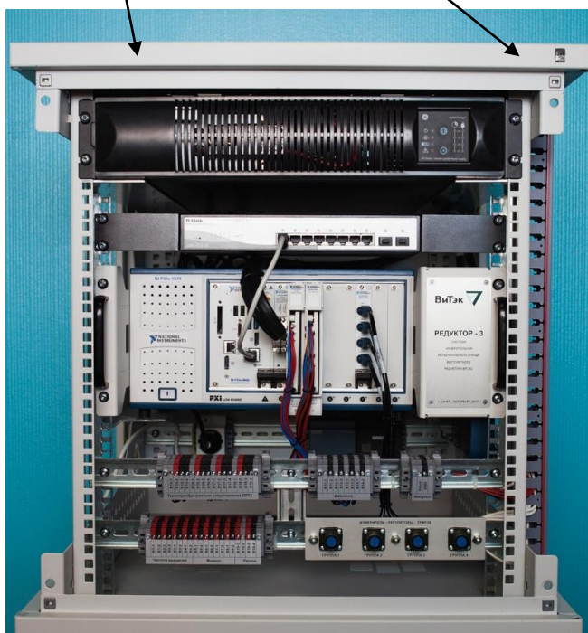
Рисунок 1 - Общий вид электромонтажного шкафа №1
