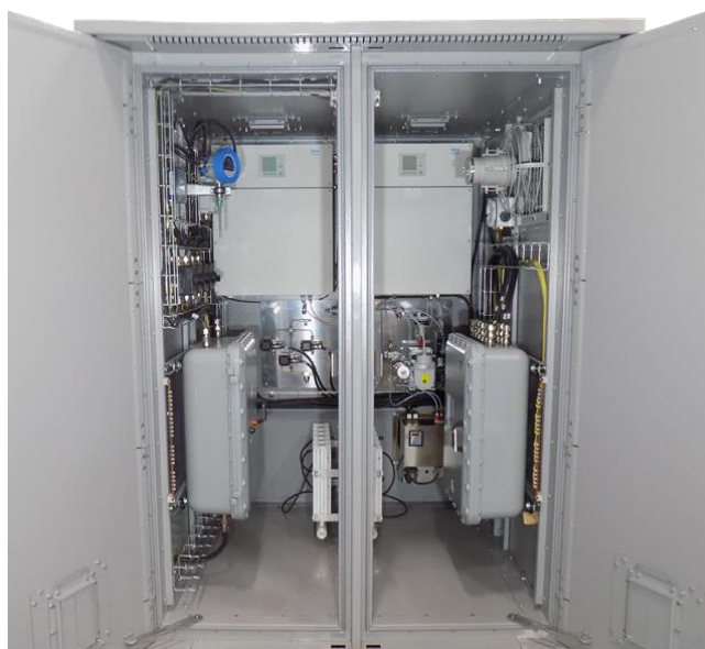
Рисунок 1 – Общий вид внутри обогреваемого шкафа с элементами комплекса
