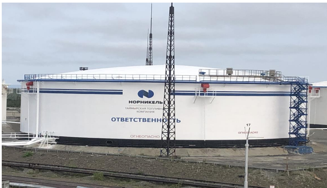
Рисунок 1. Общий вид резервуаров РВС-1000, РВС-5000, РВС-20000
