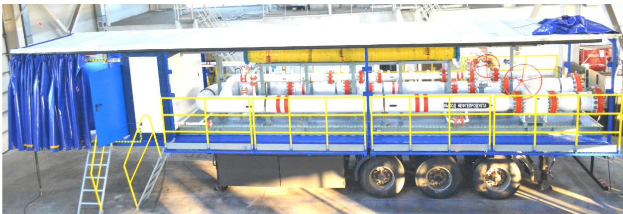
Рисунок 1 – Общий вид установки
