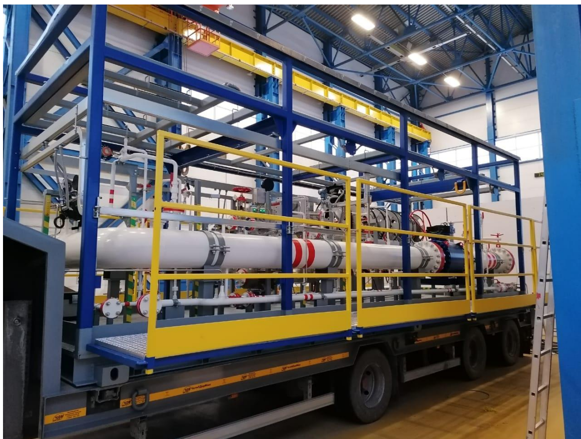
Рисунок 1 – Общий вид установки
