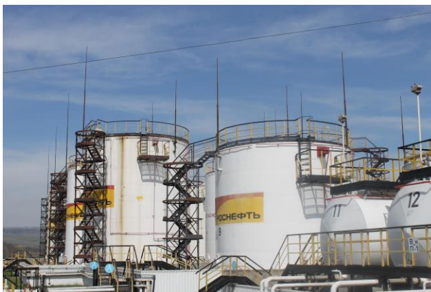
Рисунок 1 – Общий вид резервуаров стальных вертикальных цилиндрических РВСП-400, РВС-1000, РВСП-1000
