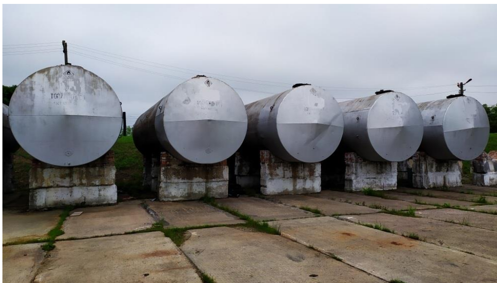
Рисунок 1 – Общий вид резервуаров стальных горизонтальных цилиндрических РГС-50
