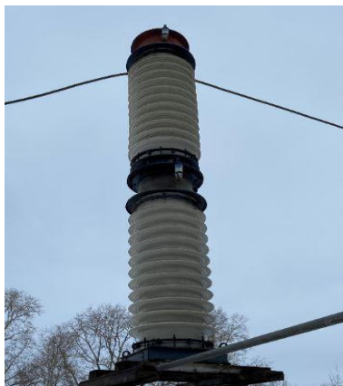
Рисунок 1 - Общий вид трансформаторов
