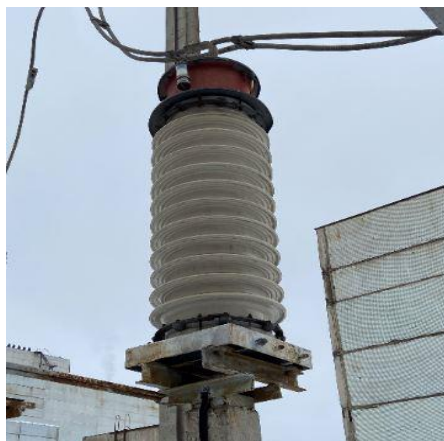
Рисунок 1 - Общий вид трансформаторов
