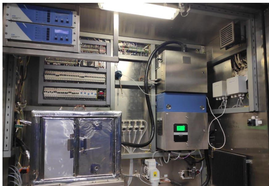
Рисунок – 2 Общий вид внутри шкафа аналитической части КТО-600:
