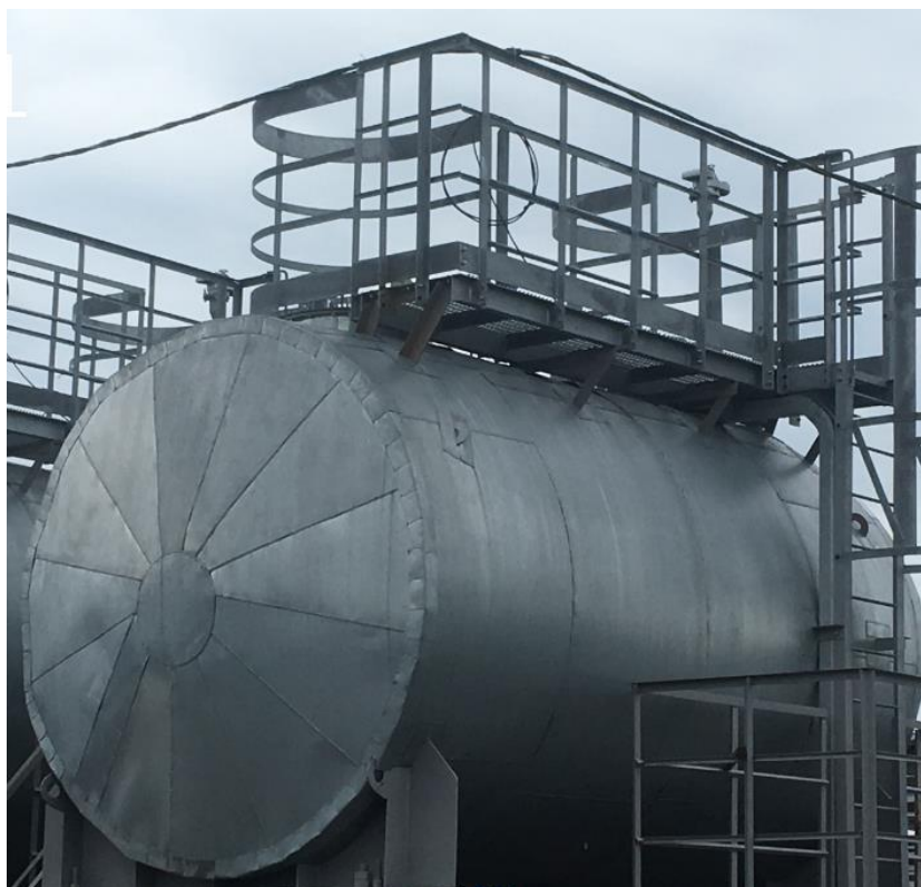
Рисунок 1 – Общий вид резервуаров РГС-25
