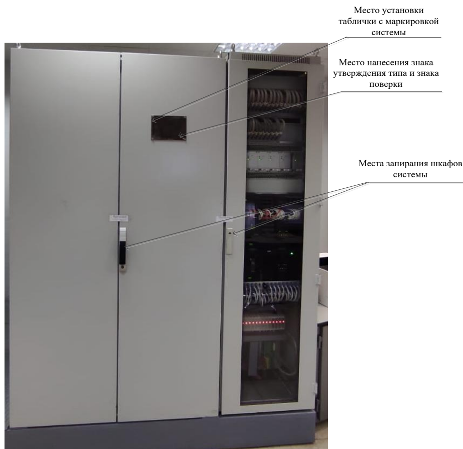
Рисунок 18 - Шкафы ША, ШК1, ШК2. Вид общий
