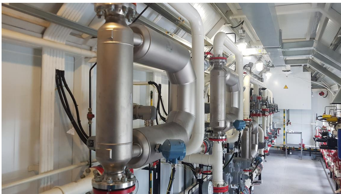
Рисунок 1 – Общий вид СИКН
