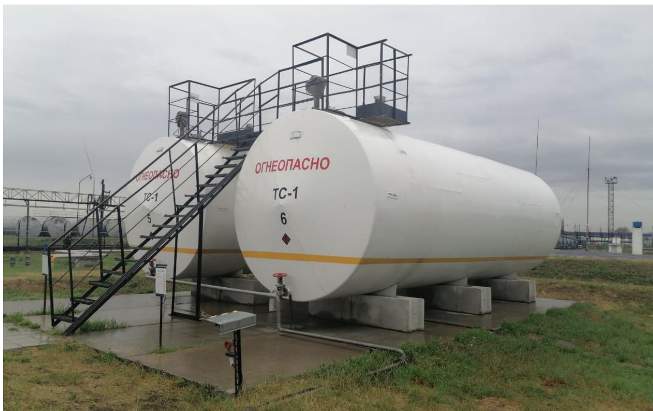
Рисунок 1 – Общий вид резервуаров РГС-75
