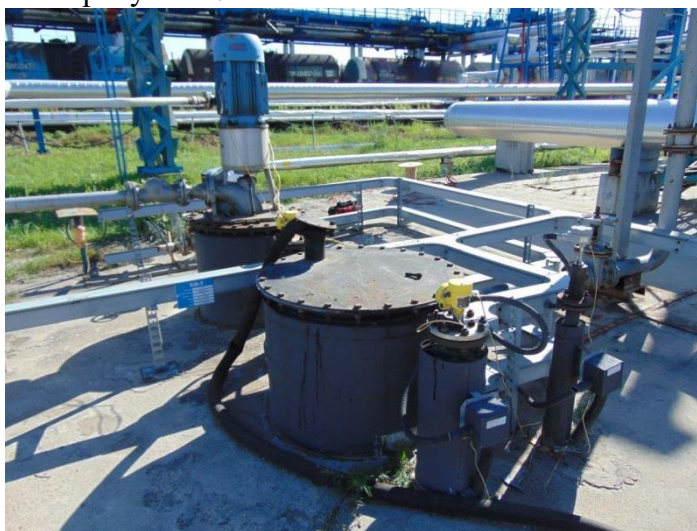
Рисунок 2 – Горловины и замерные люки резервуара стального горизонтального цилиндрического РГС-12,5
