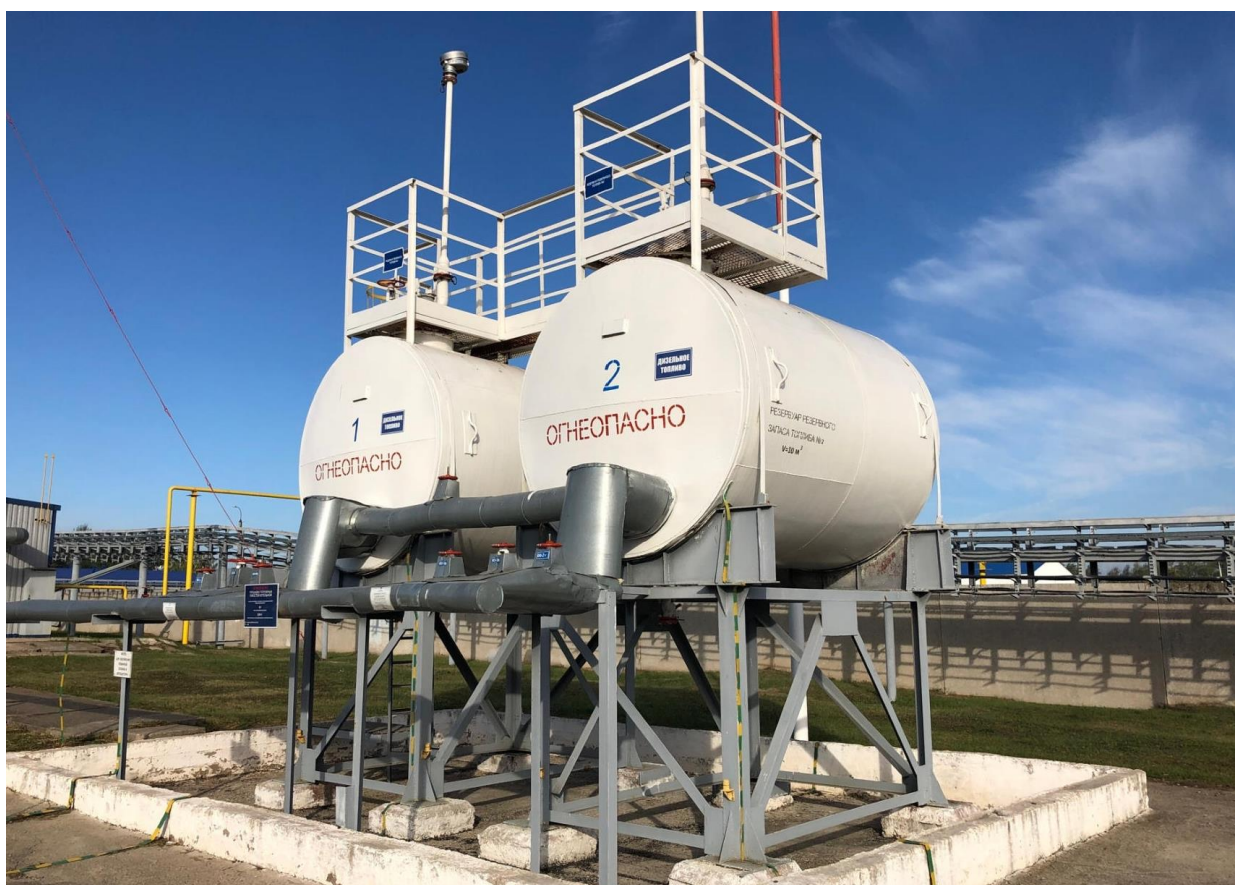
Рисунок 2 – Общий вид резервуаров РГС-10
