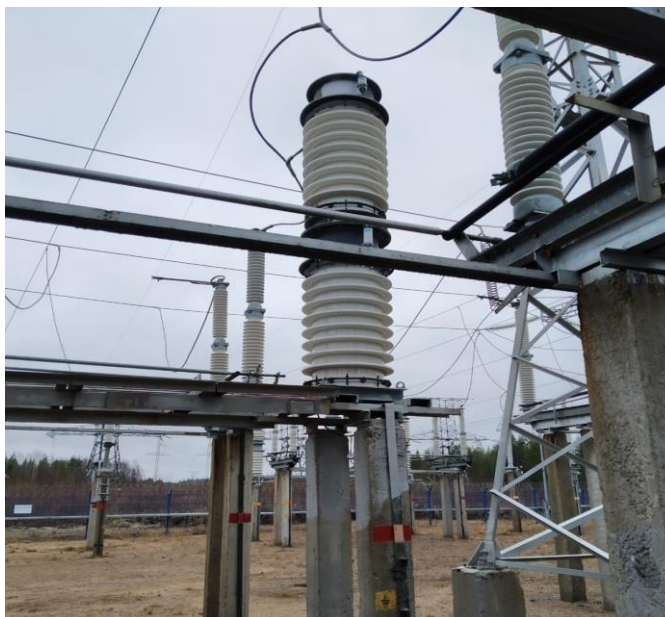
Рисунок 1 – Общий вид трансформаторов
