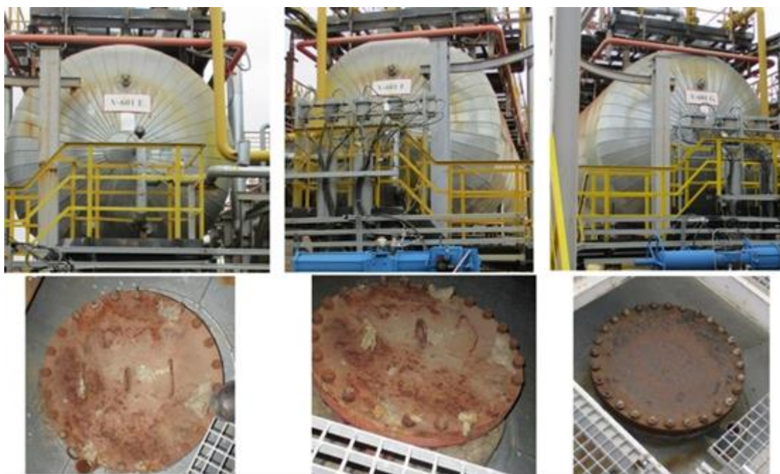
Рисунок 2 – Общий вид резервуаров стальных горизонтальных цилиндрических РГС-200 с заводскими номерами V-601 Е, V-601 F, V-601 G
