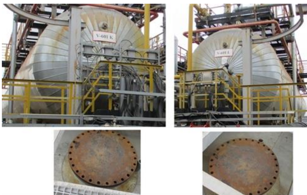
Рисунок 4 – Общий вид резервуаров стальных горизонтальных цилиндрических РГС-200 с заводскими номерами V-601 K, V-601 L
