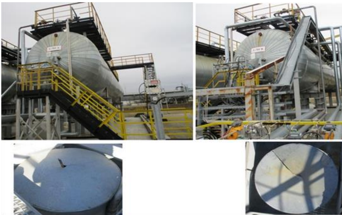
Рисунок 5 – Общий вид резервуаров стальных горизонтальных цилиндрических РГС-200 с заводскими номерами V-701 С, V-701 D
