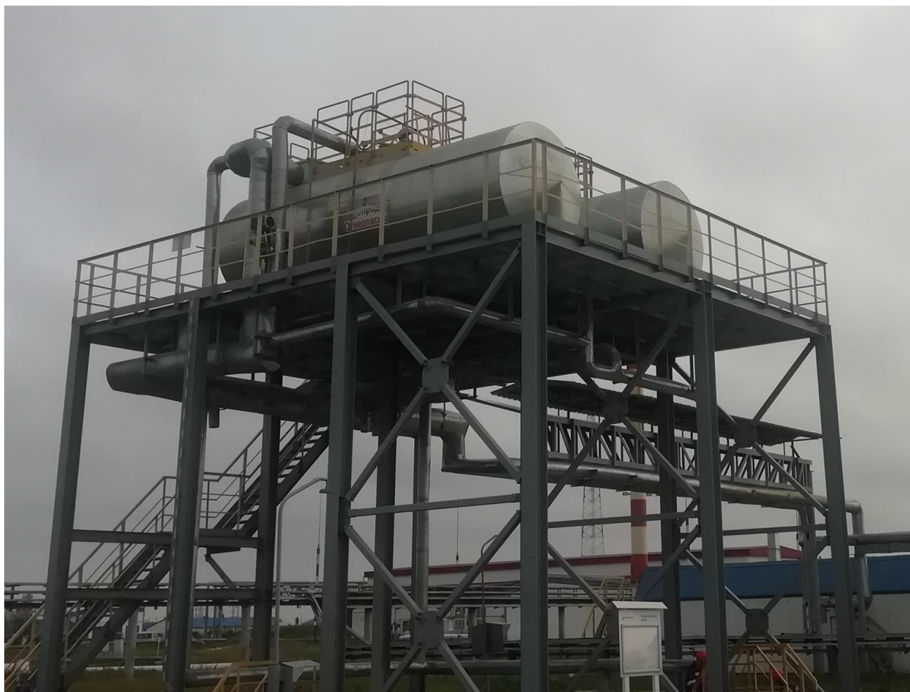
Рисунок 2 – Общий вид резервуаров РГС-20
