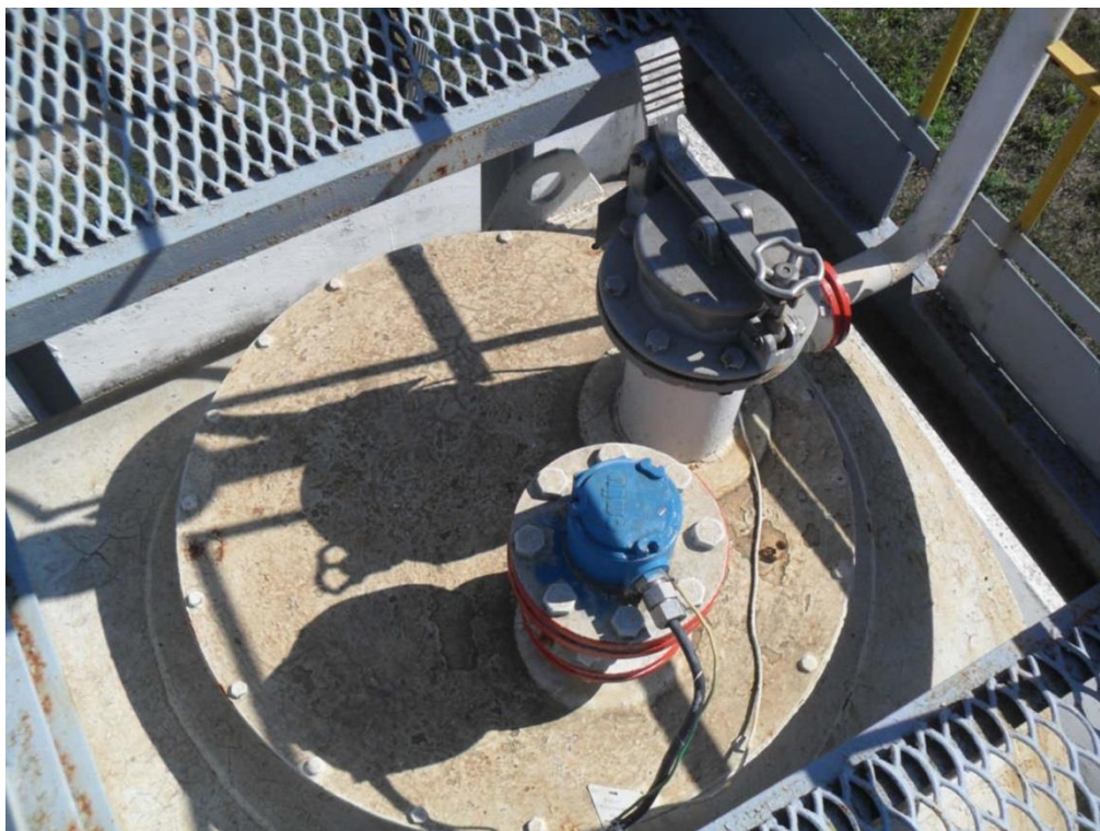
Рисунок 4 – Общий вид резервуаров РГС-5
