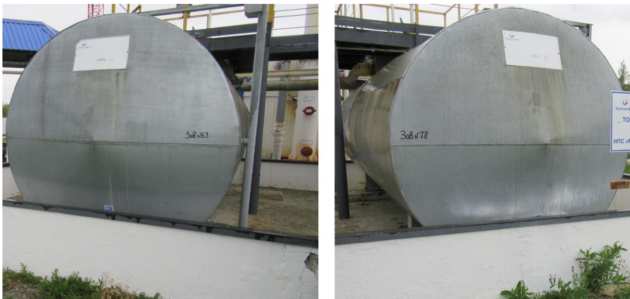
Рисунок 3 – Общий вид резервуаров РГС-20 №№63, 78
