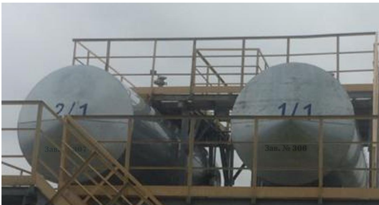
Рисунок 1 – Общий вид резервуаров РГС-20 №№306, 307
