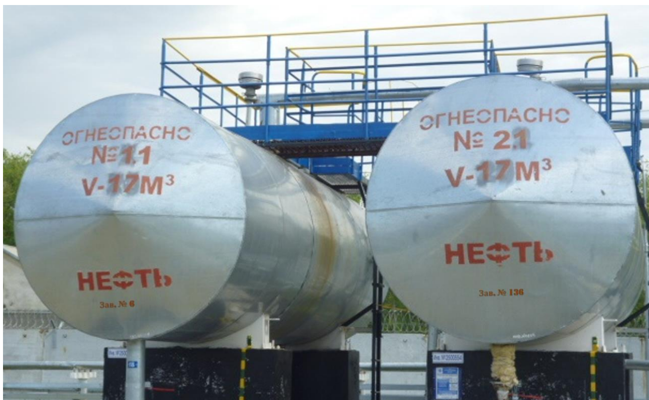
Рисунок 2 – Общий вид резервуаров РГС-20 №№6, 136
