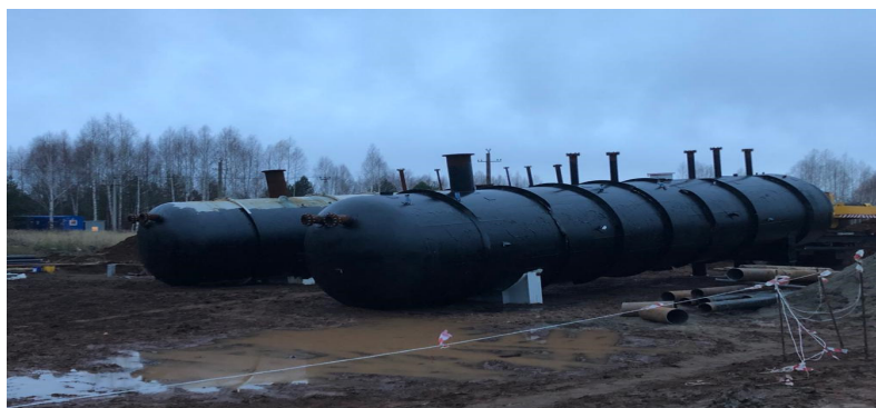
Рисунок 1 – Общий вид резервуаров стальных горизонтальных цилиндрических РГС-100
