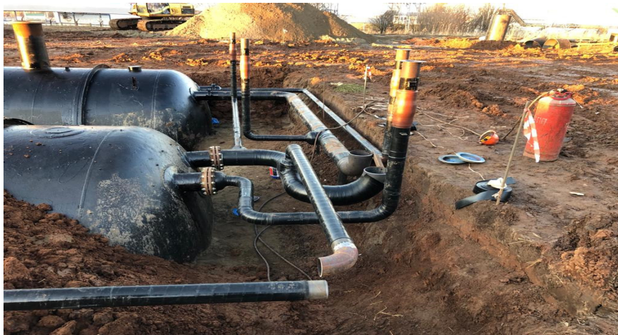
Рисунок 2 – Общий вид резервуаров стальных горизонтальных цилиндрических РГС-100
