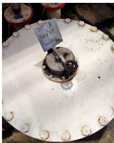
Рисунок 5 – Фотография горловины, замерного люка и заводского номера резервуара стального горизонтального цилиндрического РГС, модификации РГС-3 зав.№ VII
