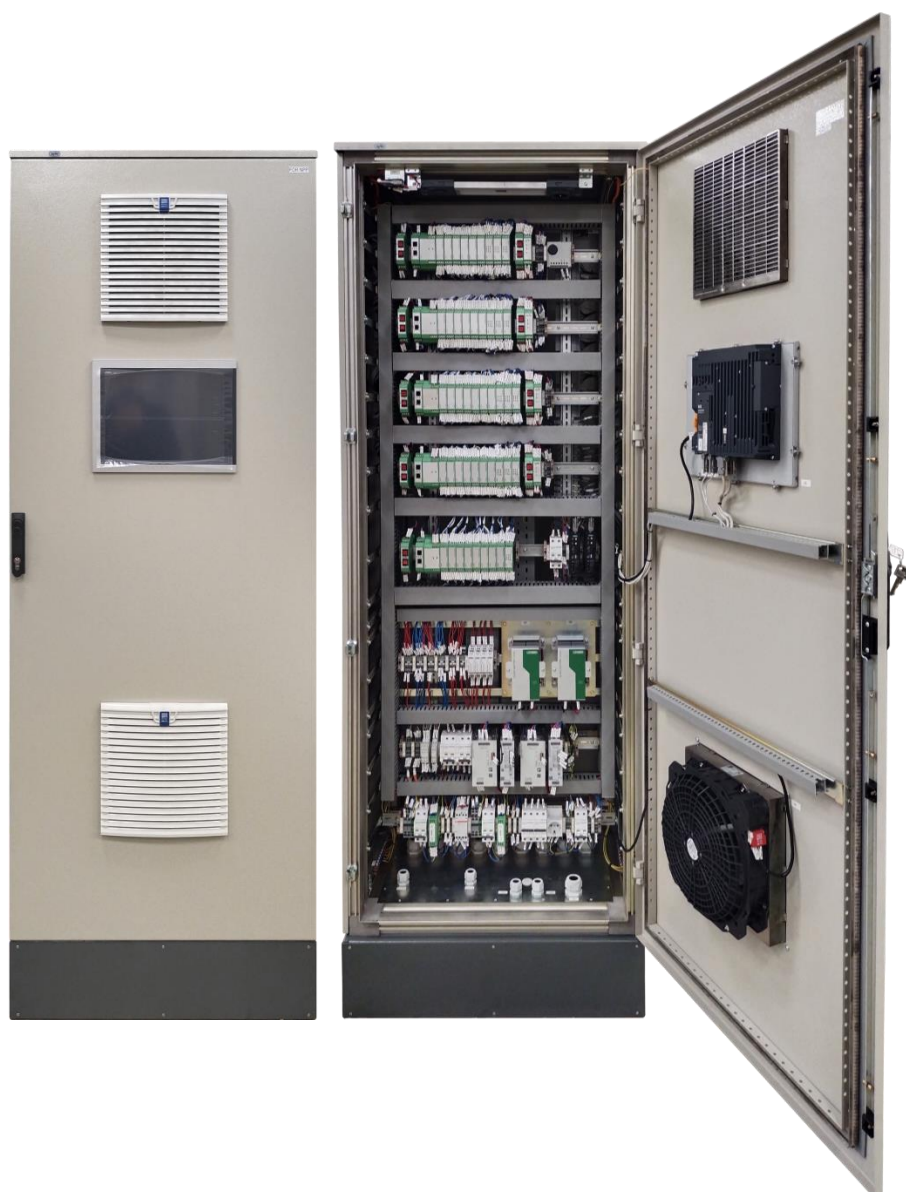
Рисунок 3 - Общий вид шкафа № 2 спереди
