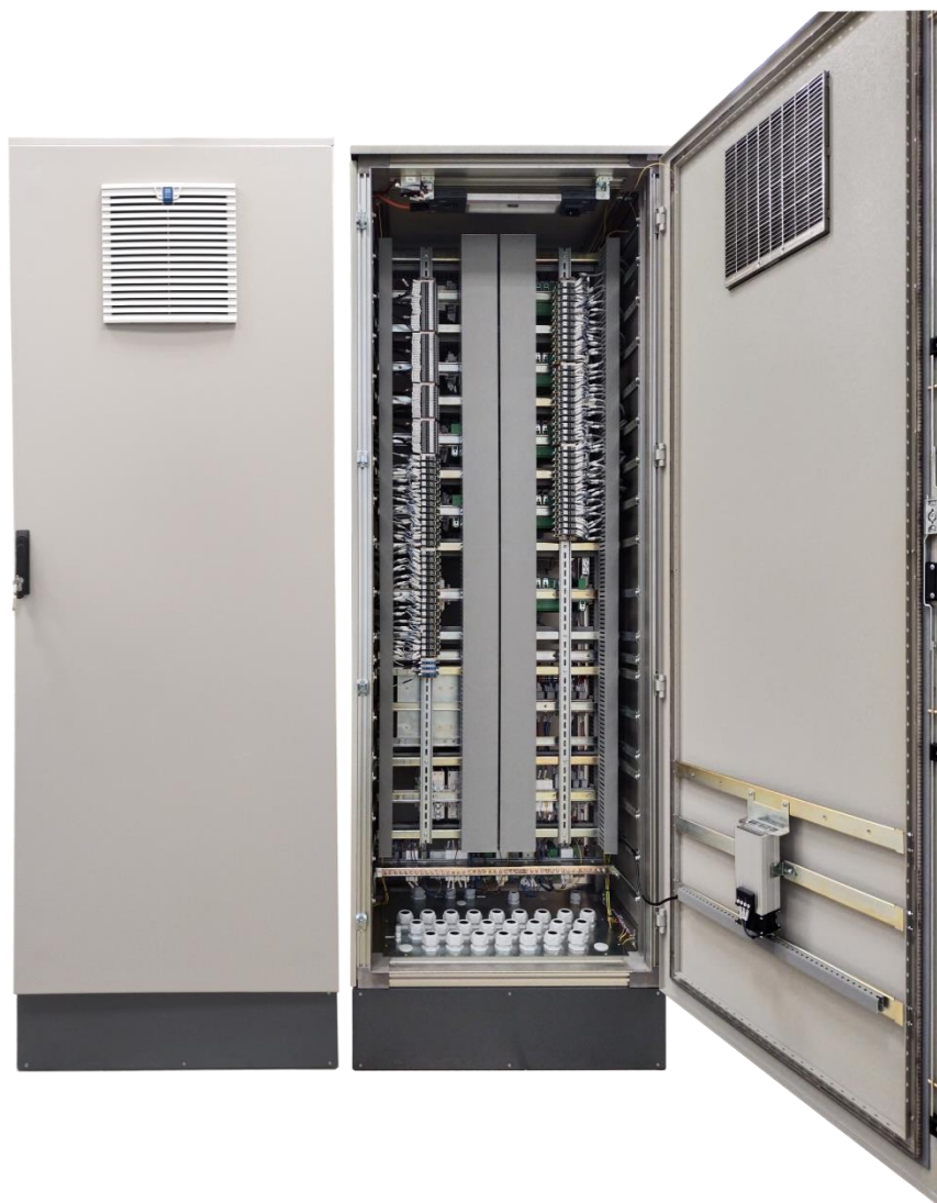
Рисунок 4 - Общий вид шкафа № 2 сзади
