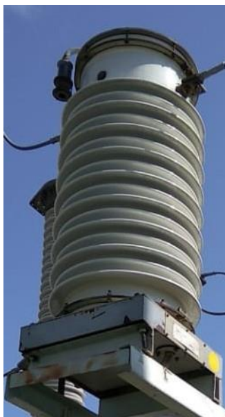
Рисунок 1 – Общий вид трансформаторов тока ТФЗМ 110Б
