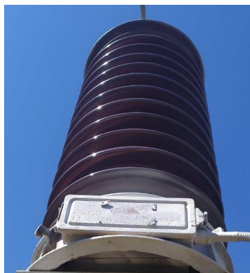
Рисунок 1 – Общий вид трансформаторов напряжения НКФ-110-57У1
