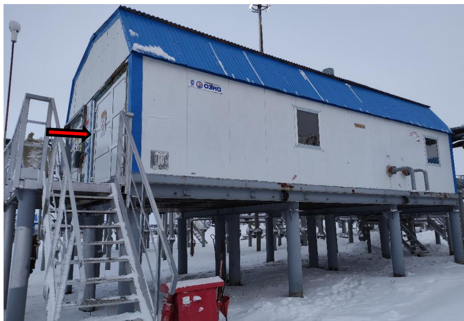
Рисунок 1 - Общий вид СИКН и место нанесения заводского номера
