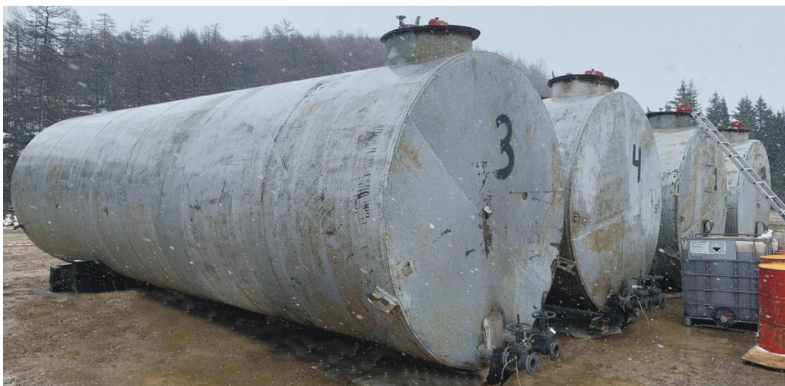
Рисунок 1 – Общий вид резервуаров РГС-50
