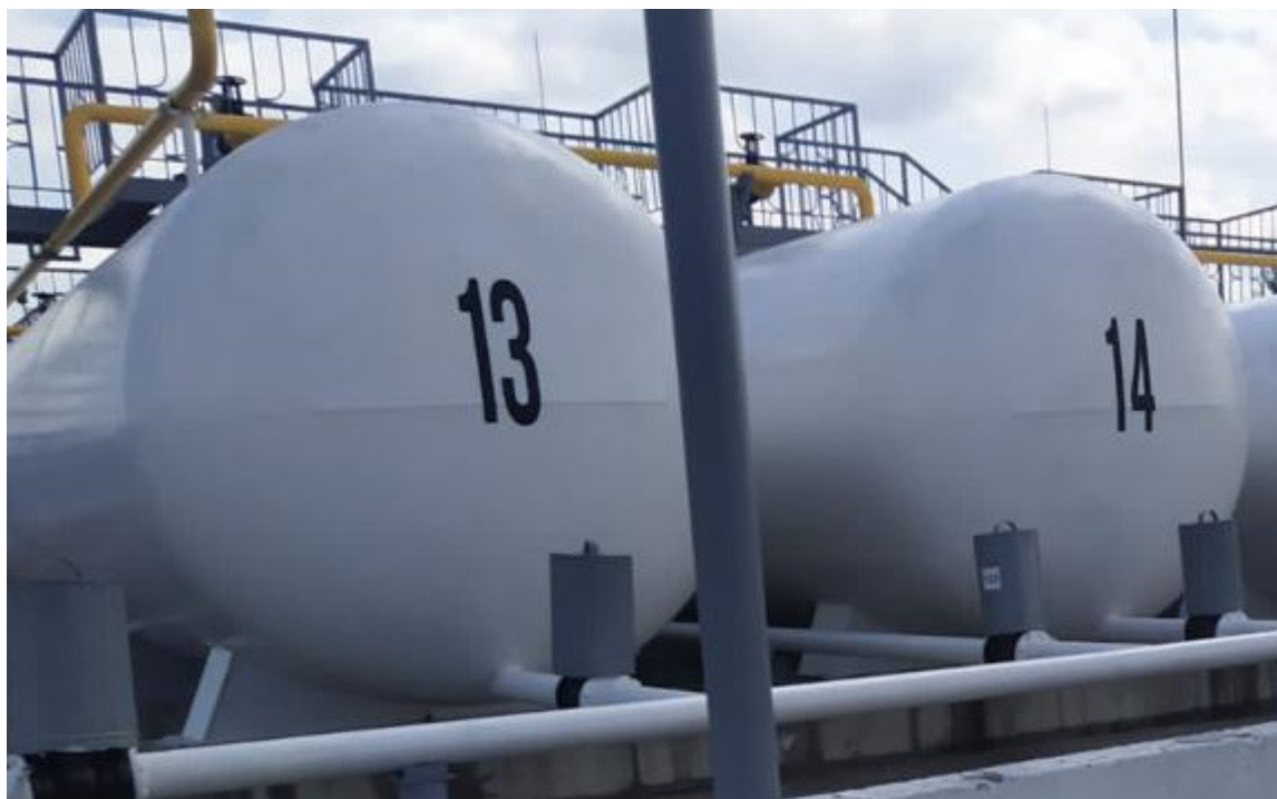
Рисунок 1 – Общий вид резервуаров РГС-75
