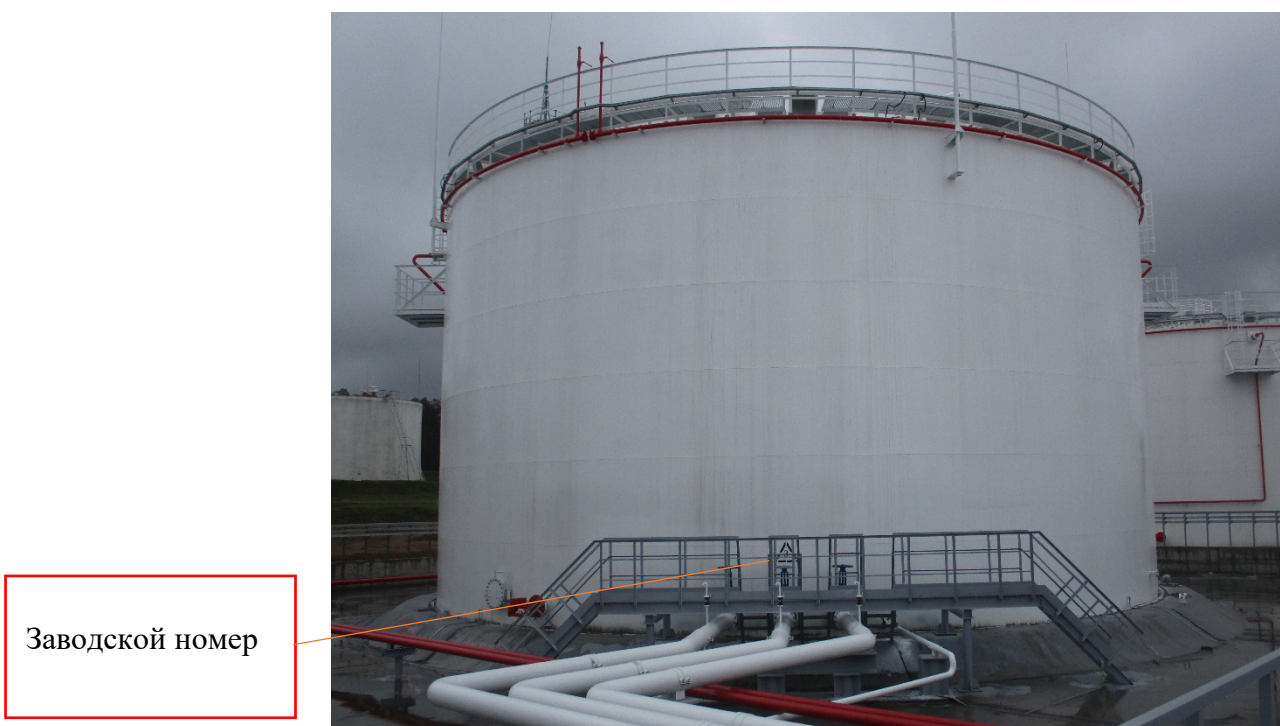
Рисунок 3 - Общий вид резервуара вертикального стального цилиндрического РВСП-5000 заводской номер 3 с указанием места нанесения заводского номера
