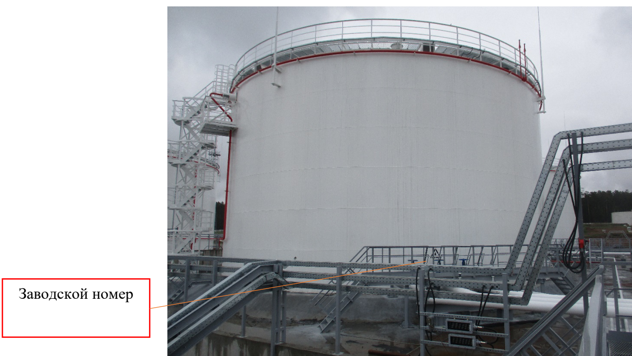
Рисунок 4 - Общий вид резервуара вертикального стального цилиндрического РВСП-5000 заводской номер 4 с указанием места нанесения заводского номера
