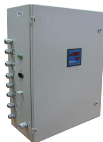
Рисунок 3 – Шкаф генератора переменного тока
