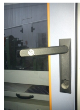
Рисунок 6 – Внешний вид замка на дверце стойки управления
