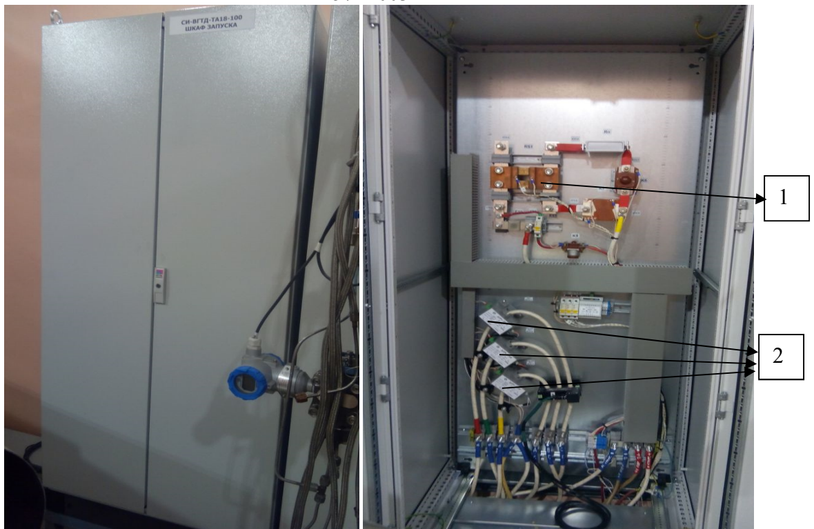
Рисунок 6 – Шкаф запуска (ШЗ)
