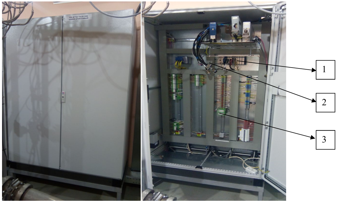
Рисунок 5 – Шкаф кроссовый (ШК)
