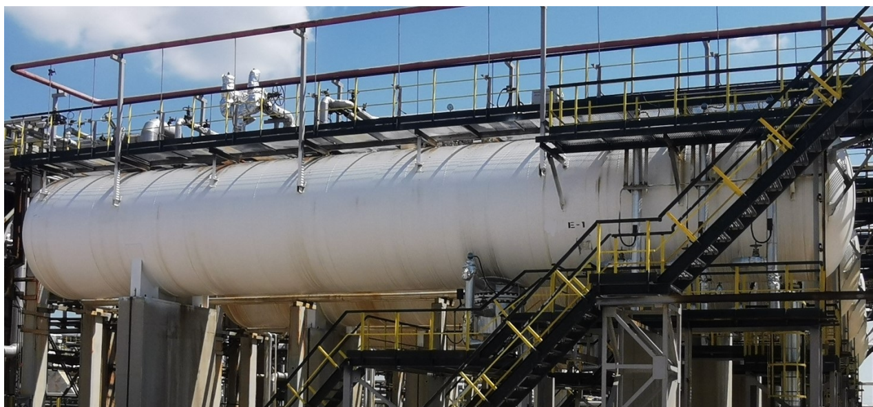
Рисунок 1 – Общий вид резервуаров РГС-200
