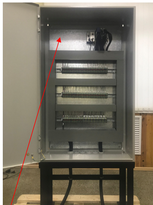
Рисунок 2 – Общий вид шкафа кроссового
