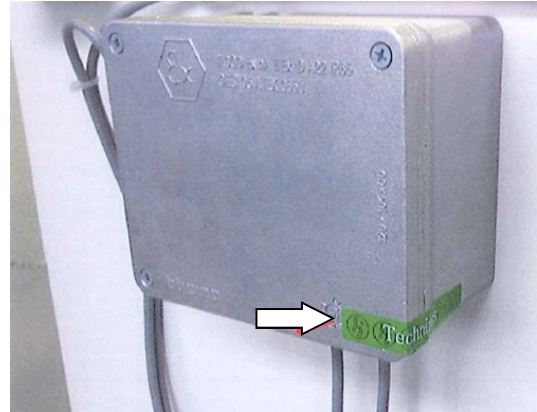
Пломбировка соединительной коробки с помощью разрушаемой наклейки (возможно также использование свинцовой (через два винта) или сургучной (мастичной) пломбы)
