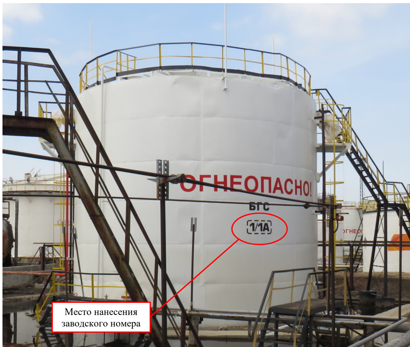
Рисунок 1 – Общий вид резервуара стального вертикального цилиндрического РВС-700 № 1/1А с указанием места нанесения заводского номера
