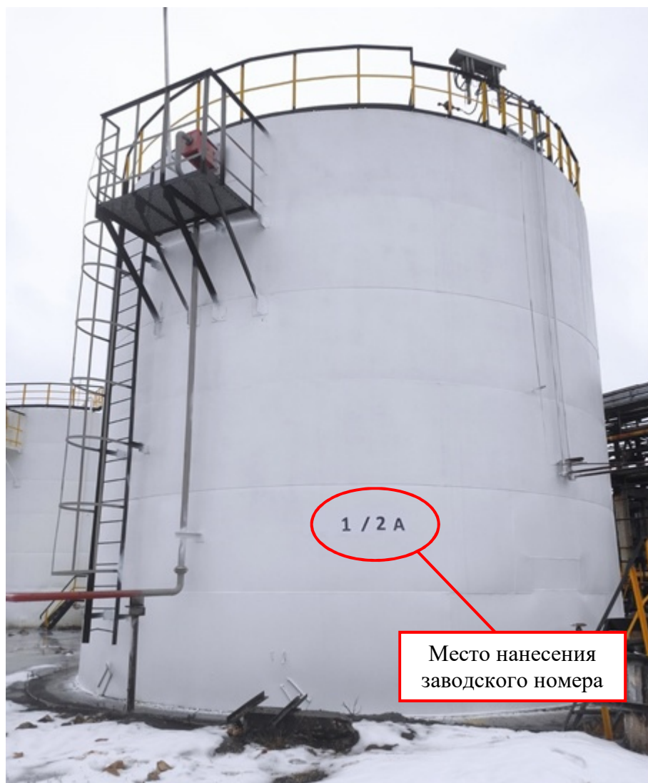
Рисунок 2 – Общий вид резервуара стального вертикального цилиндрического РВС-700 № 1/2А с указанием места нанесения заводского номера
