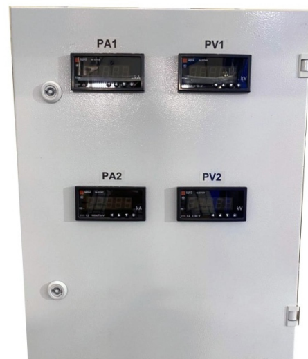
Рисунок 3 – Шкаф генератора постоянного тока
