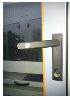
Рисунок 6 – Внешний вид замка на двери стойки управления
