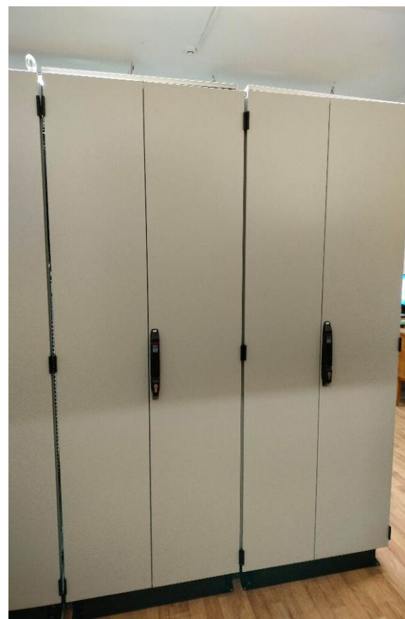
Рисунок 2 – Общий вид шкафов управления № 1 и №2 (слева направо) АСУ-С1 (вид сзади)
