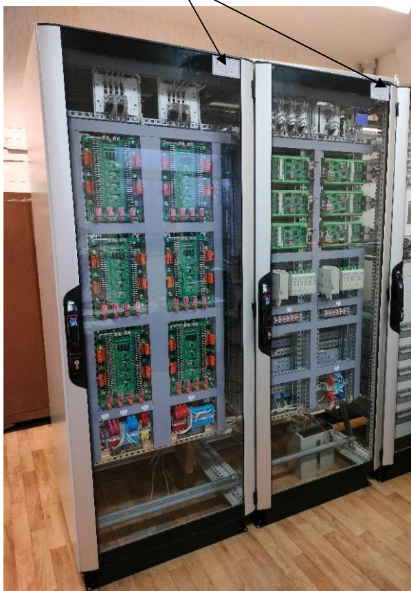
Рисунок 1 – Общий вид шкафов управления № 2 и №1 (слева направо) АСУ-С1 (вид спереди)
