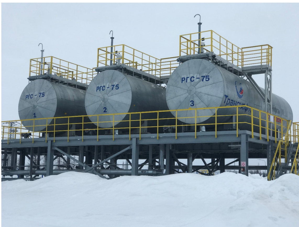
Рисунок 1 – Общий вид резервуаров РГС-75
