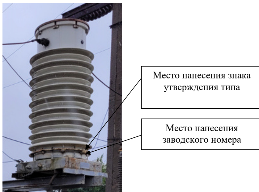
Рисунок 1 - Общий вид трансформаторов.
