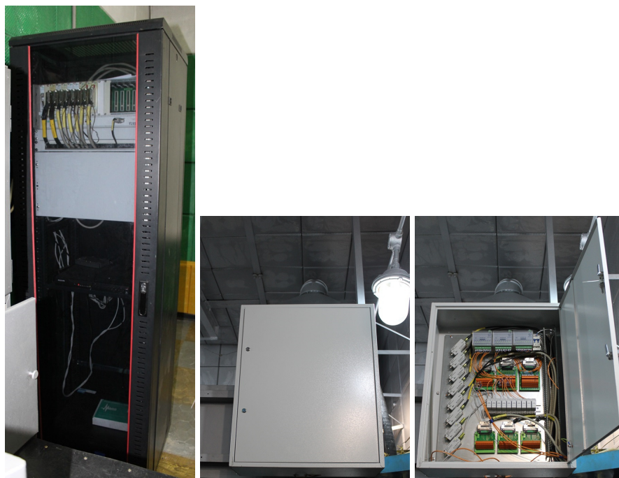
Р и с у н о к 2 – Общий вид приборных шкафов
