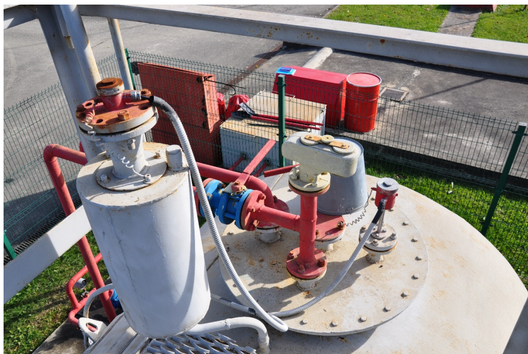
Рисунок 2 - Фотография замерного люка резервуара РГС-20Г заводской номер 32
